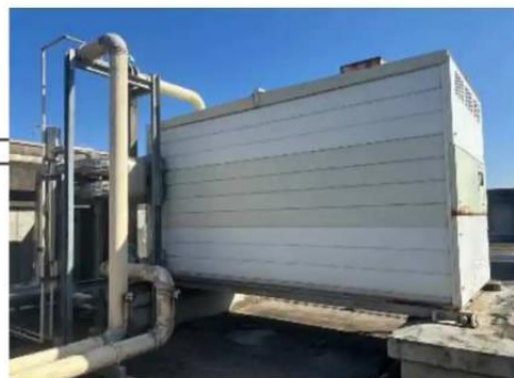
【吸収式冷温水機】
