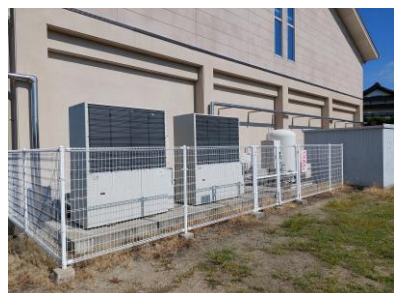
中津東体育館 LP ガス空調
