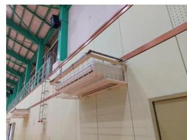
中津東体育館の空調設備
