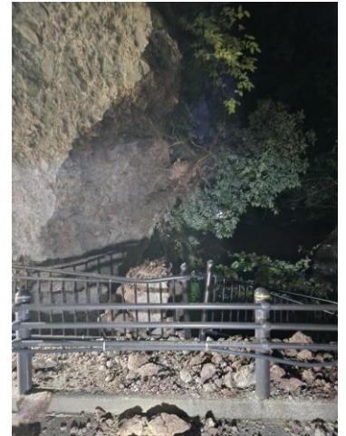
青の洞門岩盤崩落
