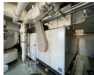
機械室内の空調設備
