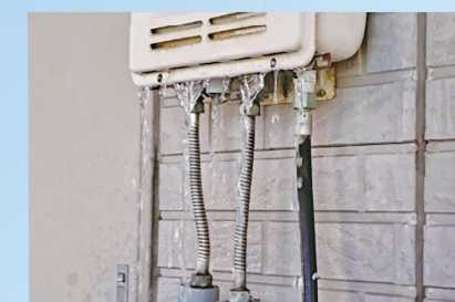
水抜きを忘れて破裂した給湯器
