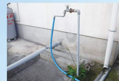
むき出しになっている水道管
