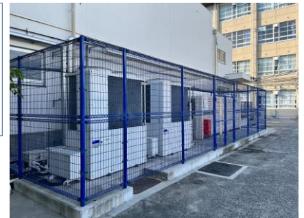
寝屋川市中学校ガス空調設備
