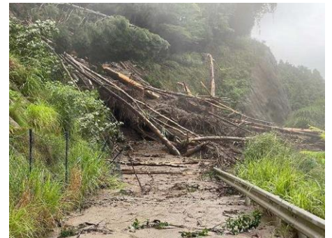
林道宇治藤原線の被災状況
