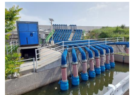
通年稼働する角木仮設ポンプ場
