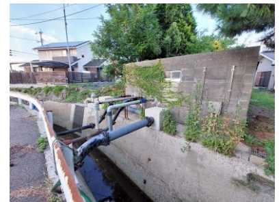
能力不足の小祝ポンプ場
