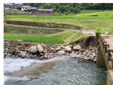
被災した耶馬溪町栃木川護岸
