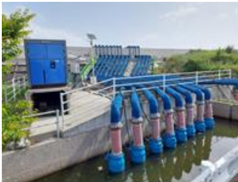
通年稼働する角木仮設ポンプ場
