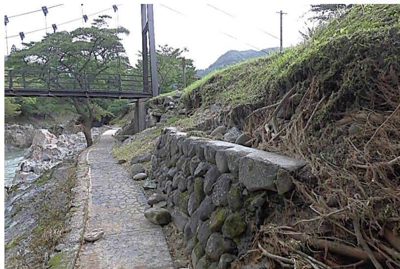
被災した猿飛千壺峡遊歩道
