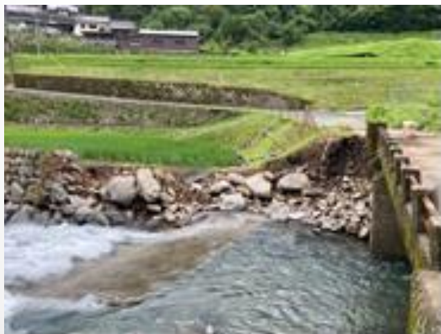
被災した耶馬溪町栃木川護岸
