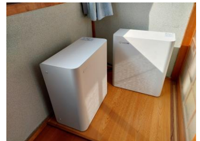
自宅の蓄電池設備
