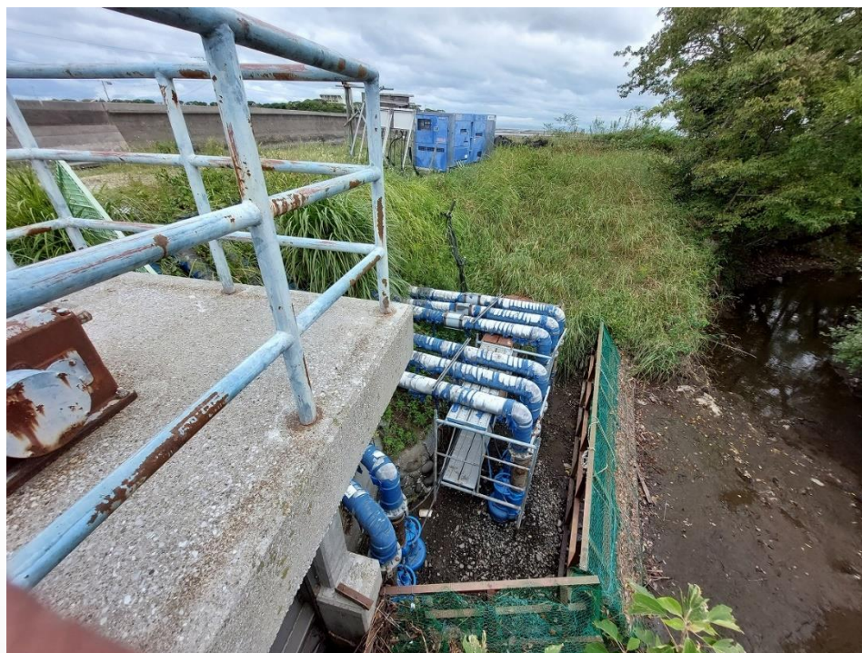
現在の東浜仮設ポンプ場
