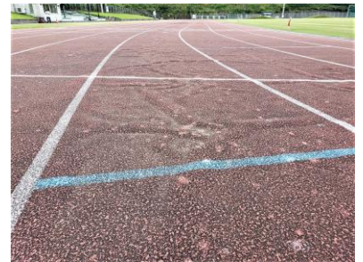
三光陸上競技場の浮上ったラバー
