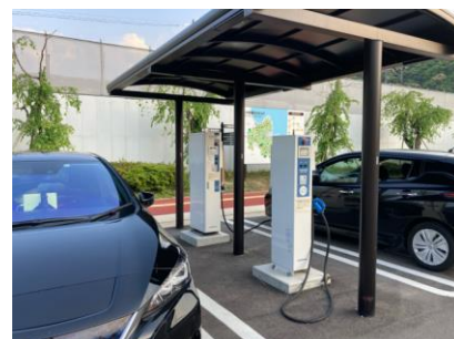
道の駅耶馬トピアの充電設備
