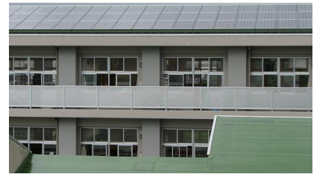
豊田小学校屋根の太陽光パネル
