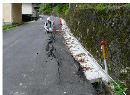
市道市平線地滑り箇所
