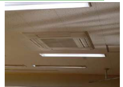
城北中に設置されたエアコン
