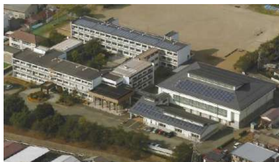
須坂市立相森中学校の太陽光パネル
