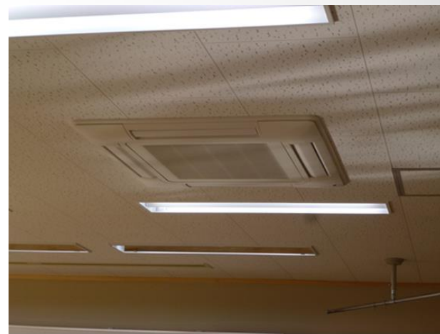
城北中のエアコン
